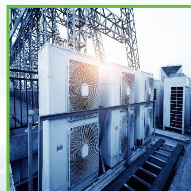
Вентиляция и кондиционирование
